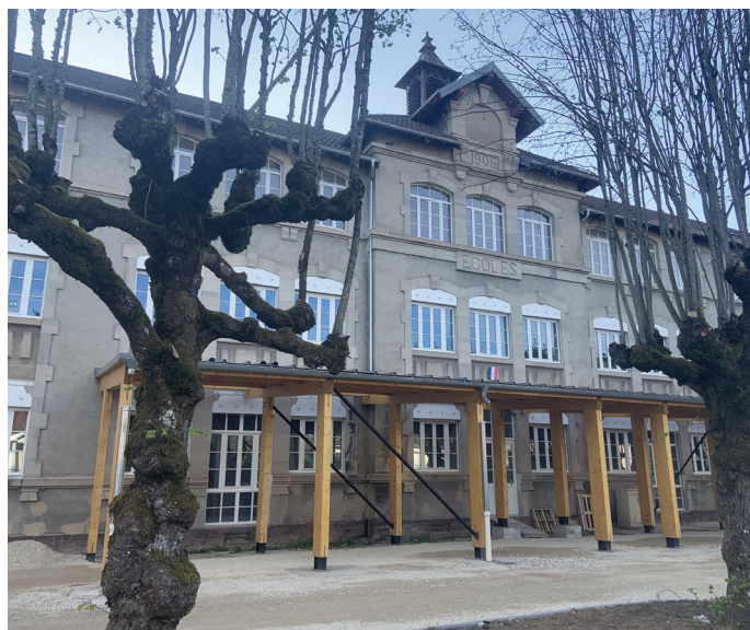
Les travaux de rénovation de l'école du boulevard Richet avancent bon train et seront achevés pour l'accueil des maternelles à la rentrée de septembre 2026
